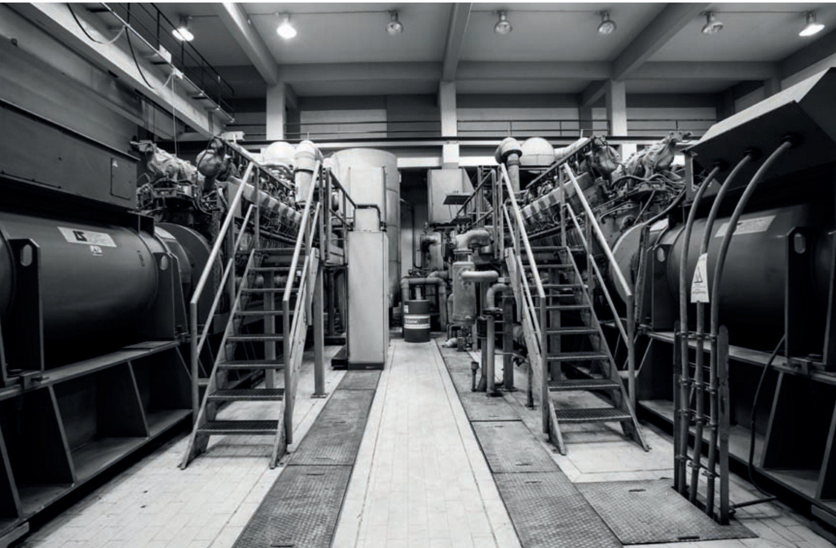
Άποψη των μηχανών Waukesha στις μονάδες συμπαραγωγής θερμικής και ηλεκτρικής ενέργειας (ΣΗΘΕ). Αξιοποίηση του βιοαερίου που παράγεται από την επεξεργασία ιλύος στις μονάδες επεξεργασίας αστικών λυμάτων
