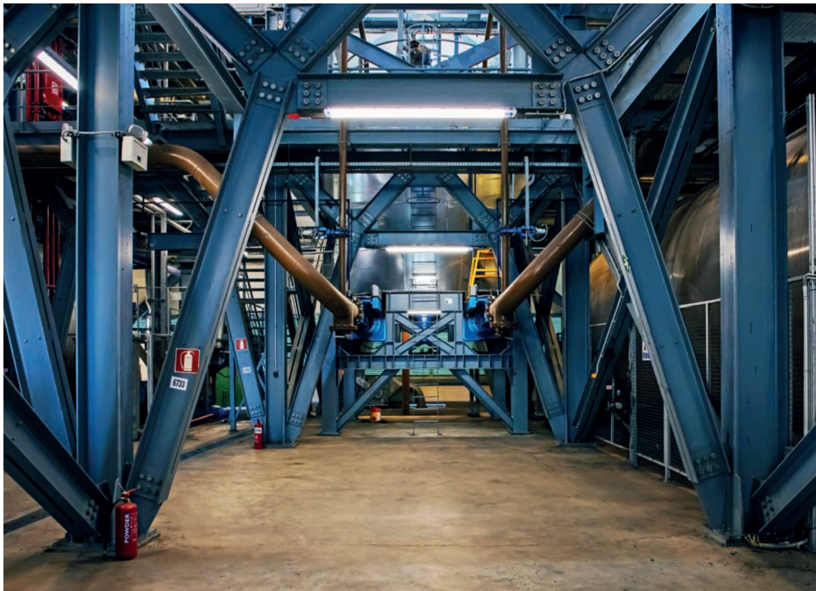
Άποψη του διαδρόμου της Μονάδας ξήρανσης του Κέντρου Επεξεργασίας Λυμάτων Ψυττάλειας. Η ξήρανση της αφυδατωμένης ιλύος που παράγεται και από τα τρία ΚΕΛ πραγματοποιείται στο Κέντρο Επεξεργασίας Λυμάτων της Ψυττάλειας
