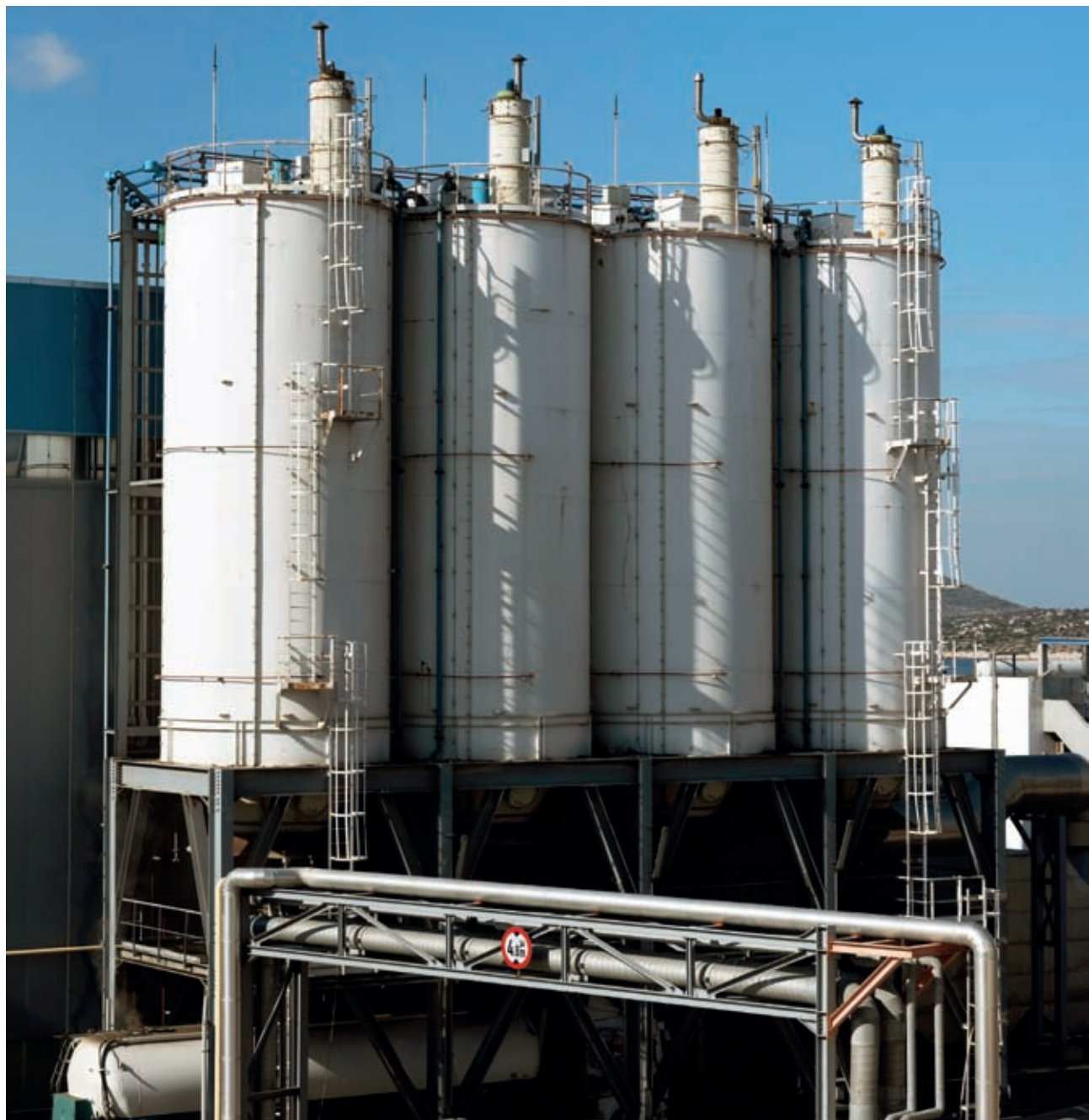
Σιλό ξηραμένης ιλύος του Κέντρου Επεξεργασίας Λυμάτων Ψυττάλειας
