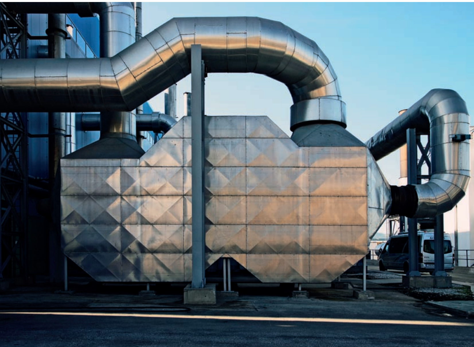
Αποψη εξωτερικού χώρου της Μονάδας ξήρανσης του Κέντρου Επεξεργασίας Λυμάτων Ψυττάλειας. Μέσω των κατάλληλων στοχευμένων παρεμβάσεων και δράσεων στις επιμέρους δραστηριότητες της εγκατάστασης, επιτυγχάνεται σημαντική μείωση των εκπομπών διοξειδίου του άνθρακα
